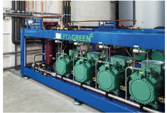
Transkritische Epta-CO 2 -Kälteanlage mit einer Kälteleistung von 300 kW.
